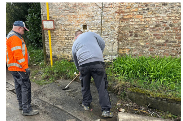
Réparation d'une chambre de visite effondrée à la rue de Walhain à Buvrines
